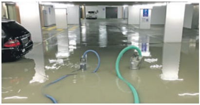
Die Feuerwehr Eschen ging mit Tauchpumpen und Wassersaugern gegen die Überflutung vor. (Foto: ZVG)
